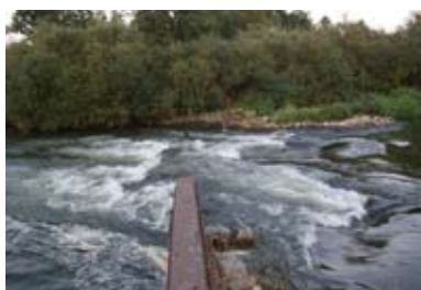
539,7 Zniszczony próg wodny w Tyczynie
