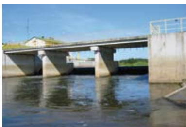
664,4 Niebezpieczny jaz w Zakrzówku
